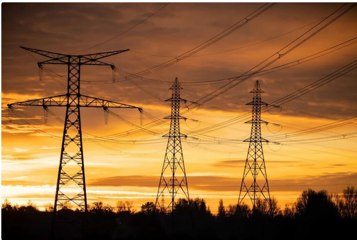
Đường dây điện cao thế tại Verfeil, Pháp. (Ảnh: AFP/TTXVN)
